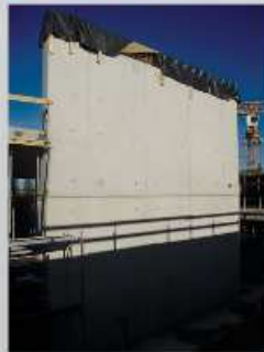
... a oto jakość betonowej ściany
